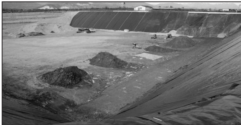
La discarica della Gedit in avanzato stato dei lavori iniziati l'11-1-2010. (Foto Mor)
